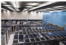
Salle de serveurs (2009)
