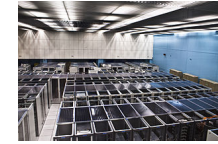
Salle de serveurs (2009)
