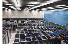
Salle de serveurs (2009)
