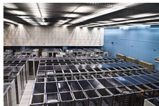
Salle de serveurs (2009)
